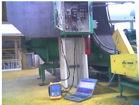
Levantamiento Eléctrico del Motor
